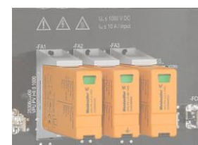
Abbildung 4: Einfache Sichtkontrolle der Überspannungsableiter
